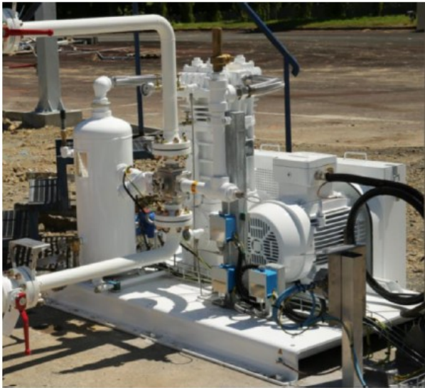
Compresseur pour le déchargement des camions citernes
